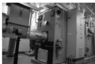
チップボイラー いつでも見学できます！
